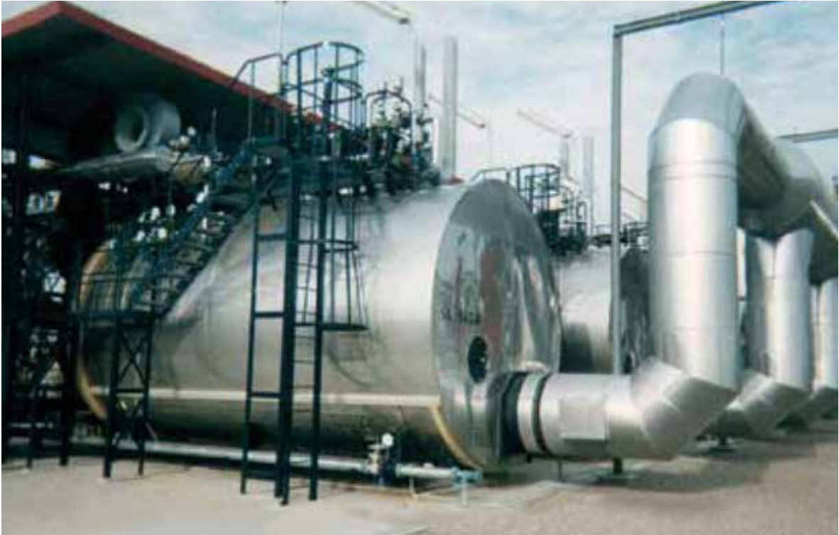
Şekil 4: Fransa'daki bir petrol firmasında kullanılan dış ortam şartlarında işletilen kazan sistemi.
