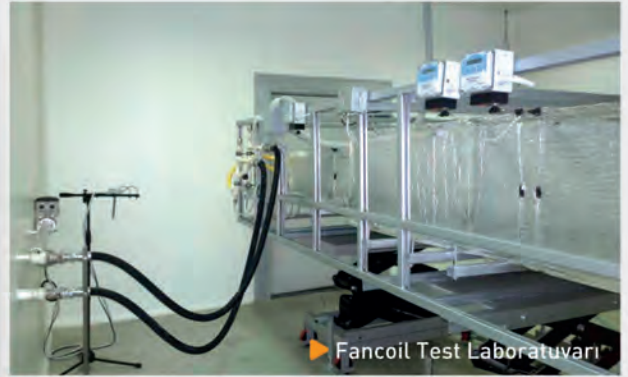
► Soğutma Grubu Test Laboratuvarı
